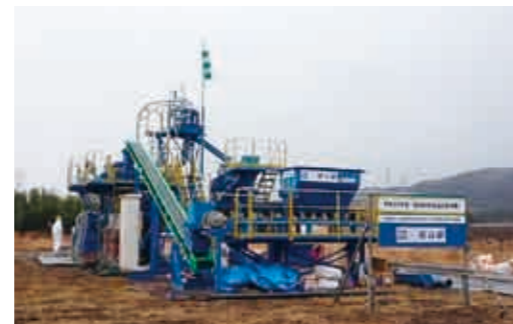
除染プラント全景（SRS：スーパーサイクロンシステム）
