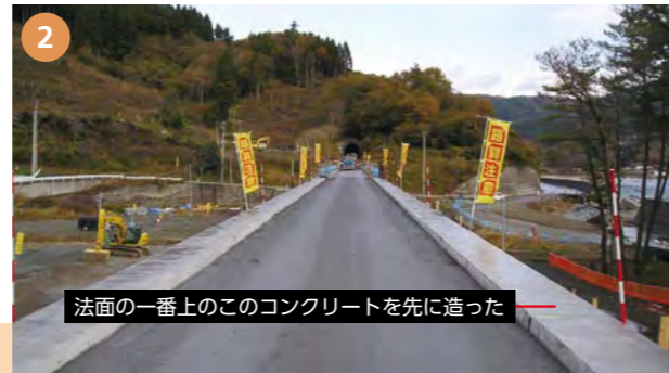
②がれきを全部どけて下地から全部作り直した。ここが壊れたのは、津波が土の空隙に入っていき、侵食して崩してしまったことによる。今回の工事では法面は張コンクリートと格子枠、一番上は舗装して(三面張り)、津波がきても土の中に水が入らないようにした
