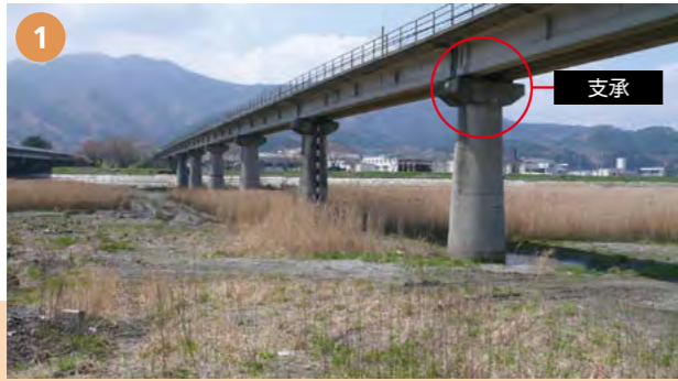
①【着工前】橋桁を受け止める支承がすべて破損し、橋桁がずれていた。橋脚も2本が座屈破損
